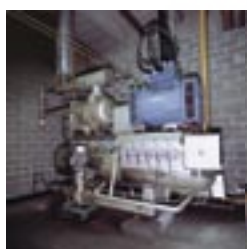
■ Gestion de surveillance de chauffage
